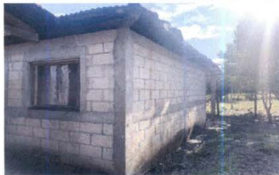
Foto 3: Láminas en pésimo estado.
