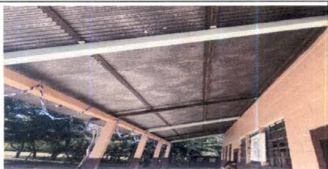
Foto 7: Laminas en mal estado por corrosión.
