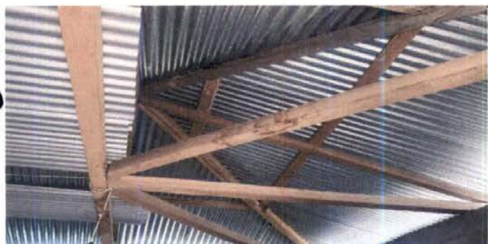
Foto 11: Estructura portante en mal estado.
